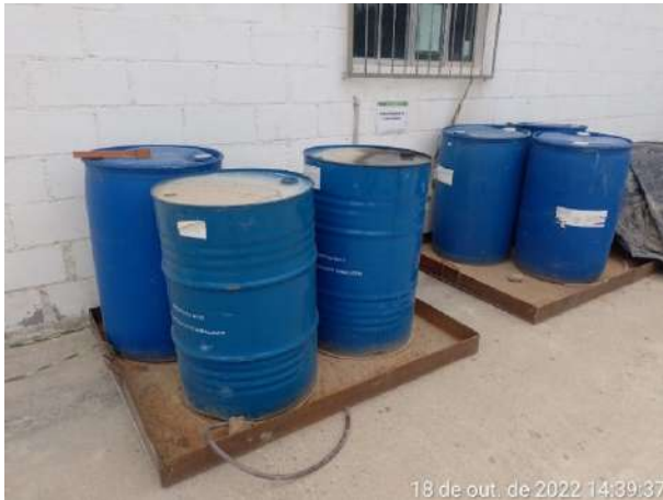
Foto 31 – Vista de tambores de aditivos dispostos em bandejas de contenção na frente de serviço. (Data:18/10/2022)
