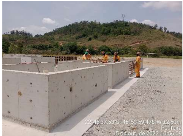
Foto 60 – Limpeza e organização na frente de serviço do Pátio de Pré-Moldados. (Data:15/10/2022)
