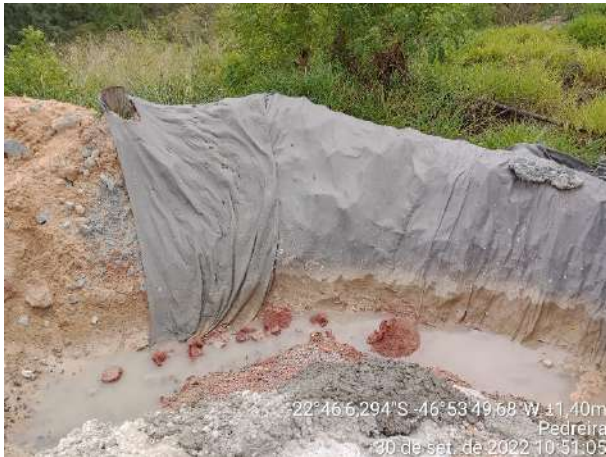
Foto 179 – Sistema de Tratamento de Efluentes utilizado para coleta de amostras de concreto das betoneira, junto ao laboratório de ensaio canteiro industrial. (Data:30/09/2022)
