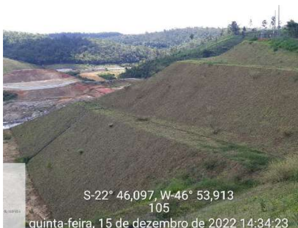
Foto 178 – Canaleta de berma para a coleta de águas pluviais que escoam na superfície do talude. (Data:15/12/2022)
