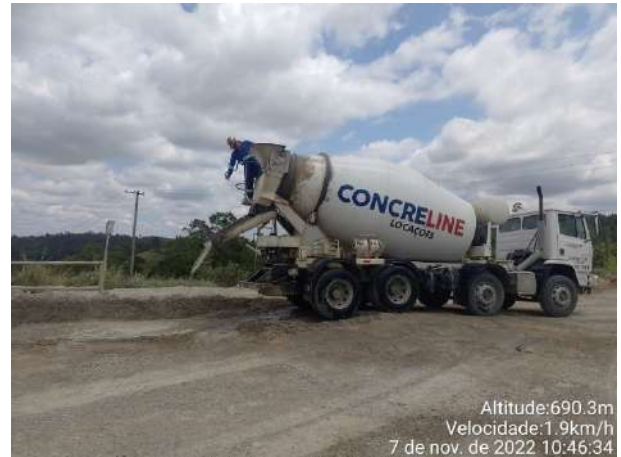
Foto 184 – Sistema de Tratamento de Efluentes para lavagem de bicas de betoneira no canteiro da usina de concreto. (Data:07/11/2022)
