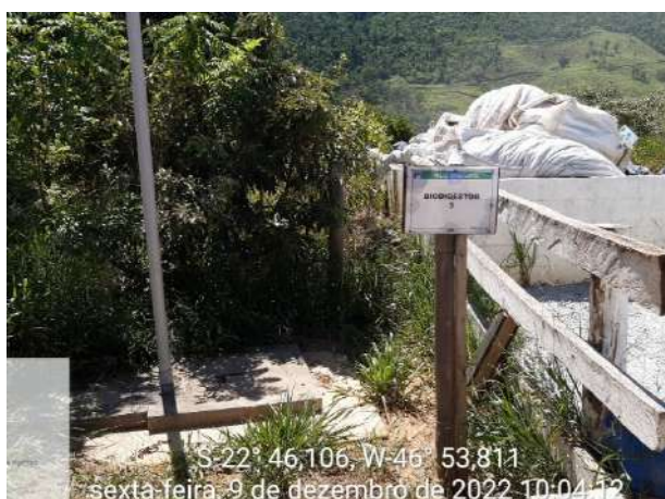
Foto 205 – Biodigestor 03 no Canteiro Industrial. (Data:09/12/2022)
