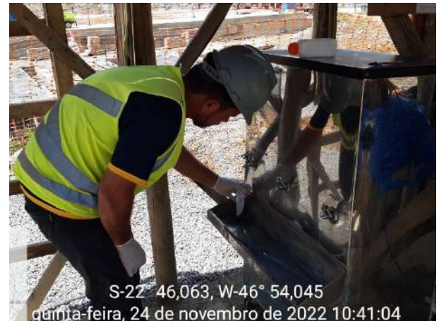
Foto 80 – Coleta de água para análise de potabilidade – Bebedouro da Fundação. (Data:24/11/2022)
