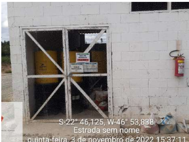
Foto 35 – Vista geral da baía de armazenamento de Produtos Perigosos na oficina mecânica. (Data:03/11/2022)
