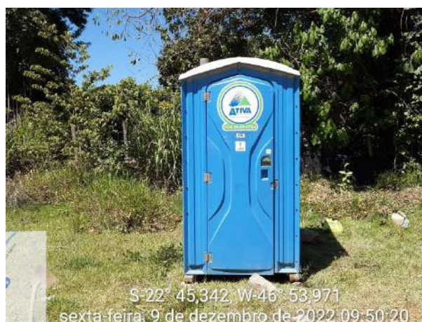
Foto 206 – Vista do sanitário químico disponível na frente de serviço. (Data:09/12/2022)
