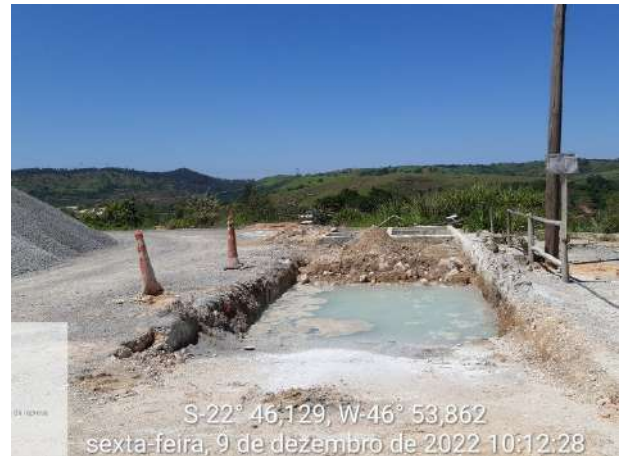
Foto 186 – Sistema de Tratamento de Efluentes para lavagem de bicas de betoneira no canteiro da usina de concreto. (Data:09/12/2022)
