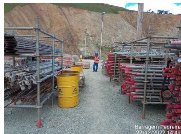
Foto 68 – Limpeza e organização local de trabalho de armazenamento de formas e tubo Rolls na margem direita (Data: 22/12/2022)
