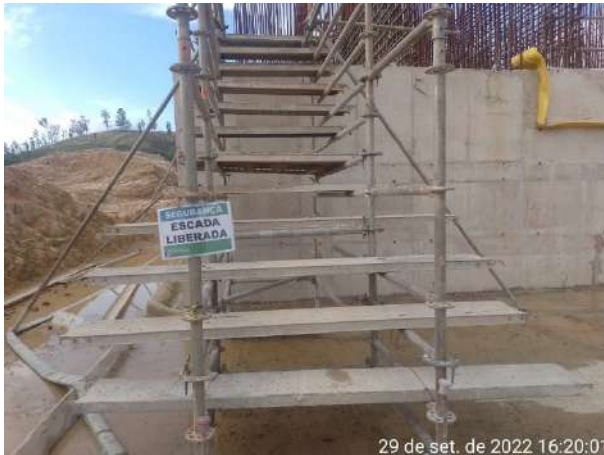
Foto 151 – Sinalização de liberação de acesso implantada em escada na frente de serviço. (Data:29/09/2022)
