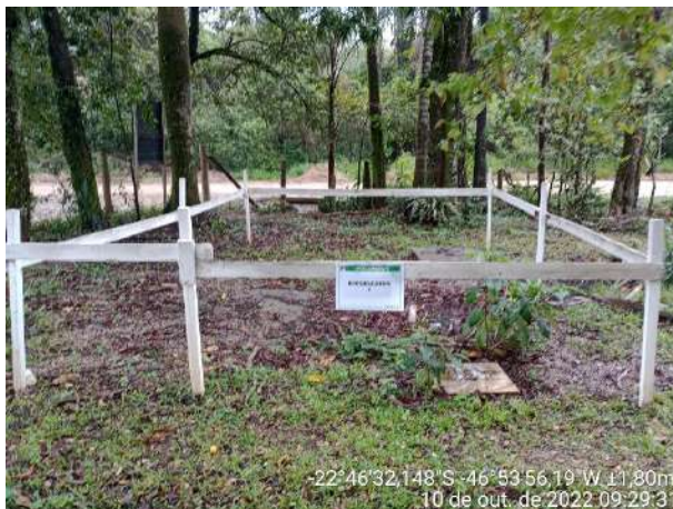
Foto 195 – Biodigestor 01 no canteiro administrativo. (Data:10/10/2022)
