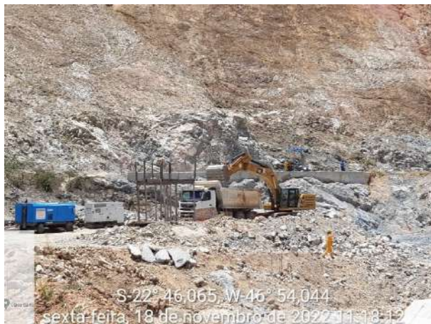
Foto 257 – Vista geral das atividades construtivas na frente de serviço da fundação. (Data:18/11/2022)
