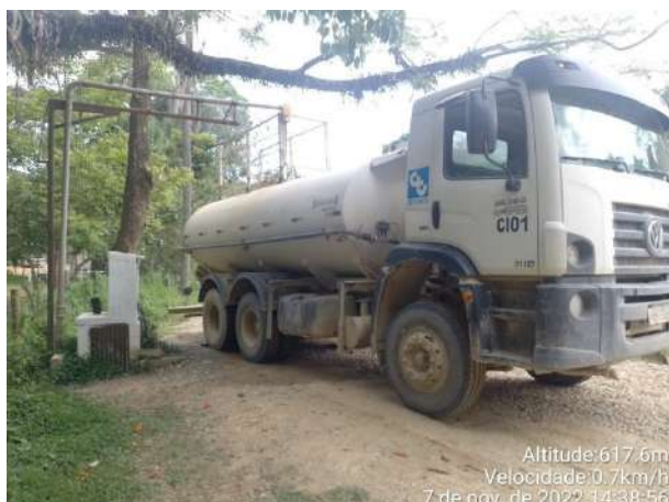
Foto 215 – Abastecimento do Caminhão-Pipa para a realização da umectação das vias internas e externas da obra (Data:07/11/2022)
