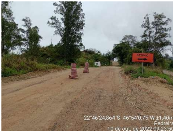
Foto 153 – Sinalização vertical implantada em via interna. (Data:10/10/2022)
