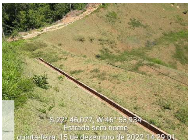
Foto 177 – Canaleta de berma para a coleta de águas pluviais que escoam na superfície do talude. (Data:15/12/2022)
