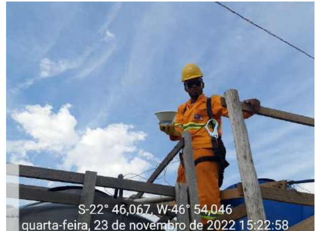
Foto 78 – Adequação de dosagem de cloro na caixa de água disposta na frente de serviço. (Data:23/11/2022)
