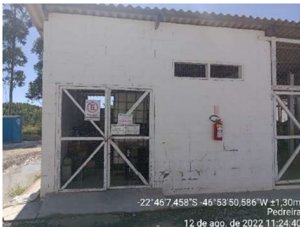
Foto 29 – Vista geral da baia de armazenamento de Produtos Perigosos na Oficina Mecânica. (Data:12/09/2022)
