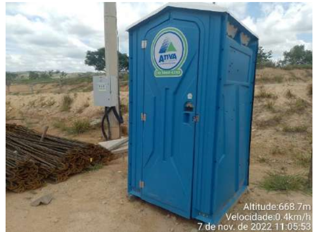
Foto 200 – Vista do sanitário químico disponível na frente de serviço. (Data:07/11/2022)
