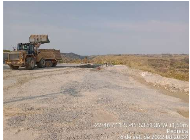
Foto 180 – Sistema de Tratamento de Efluentes para lavagem de bicas de betoneira no canteiro industrial. (Data:06/09/2022)
