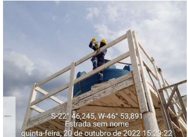
Foto 74 – Adequação de dosagem de cloro na caixa de água disposta na frente de serviço. (Data:20/10/2022)
