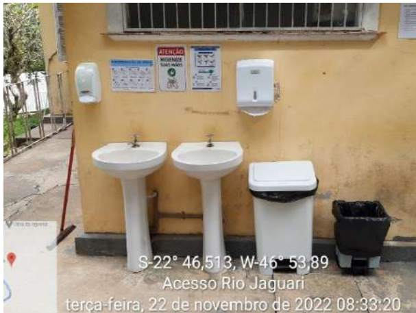
Foto 113 – Lavatório provido de sabão e álcool em gel na entrada do canteiro administrativo. (Data:22/11/2022)
