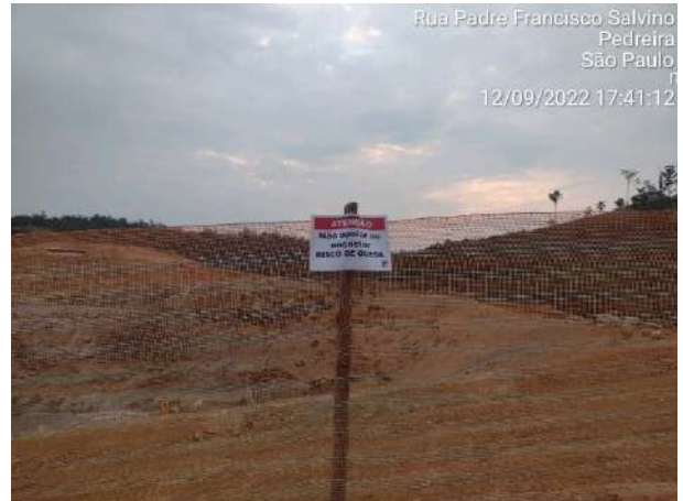
Foto 152 – Sinalização de advertência implantada em isolamento de cerquite na frente de serviço. (Data:12/09/2022)
