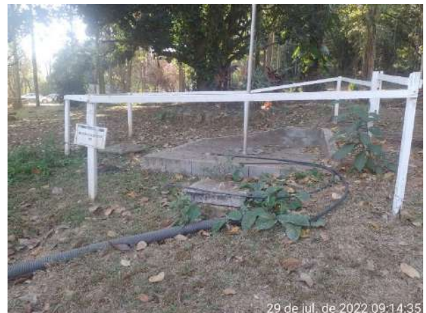
Foto 208 – Biodigestor 02 no canteiro administrativo. (Data: 16/12/2022)
