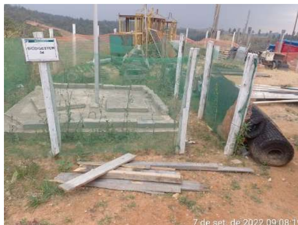
Foto 210 – Biodigestor 04 no Canteiro Industrial. (Data:07/09/2022)
