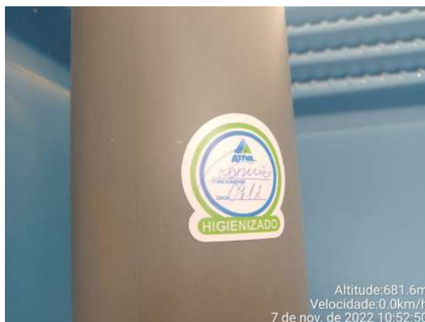
Foto 201 – Vista do selo de identificação da higienização dos efluentes. (Data:04/11/2022)
