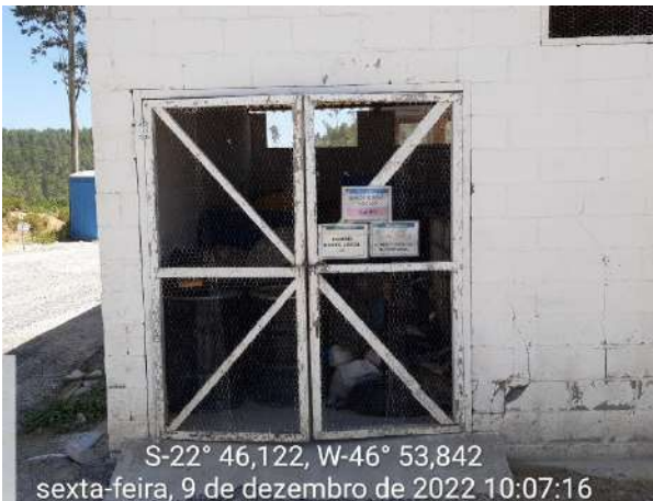
Foto 39 – Vista geral da baía de armazenamento de Produtos Perigosos na oficina mecânica. (Data:09/12/2022)
