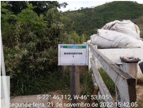
Foto 199 – Biodigester 03 no Canteiro Industrial. (Data:21/11/2022)
