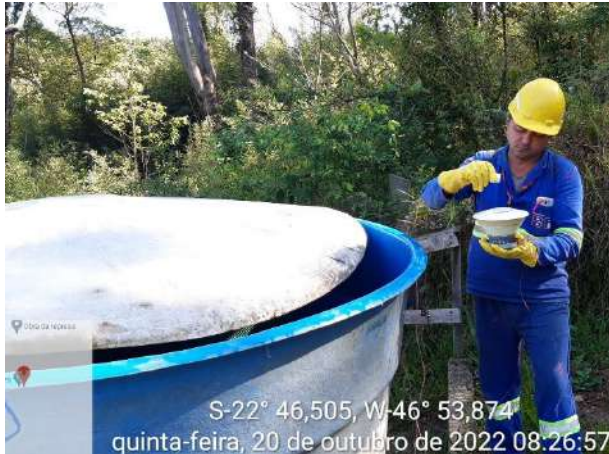
Foto 73 – Adequação de dosagem de cloro na caixa de água disposta na frente de serviço. (Data:20/10/2022)
