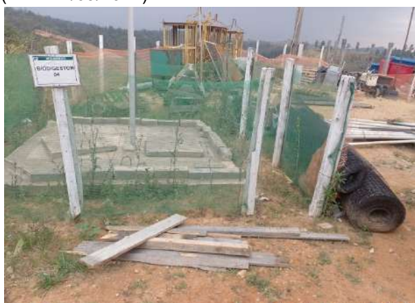
Foto 189 – Biodigestor 04 no Canteiro Industrial. (Data:07/09/2022)
