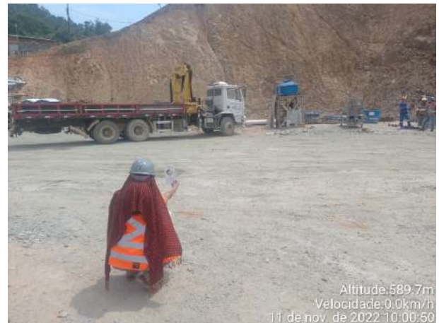
Foto 222 – Medição de fumaça preta em caminhão guindaste. (Data:11/11/2022)
