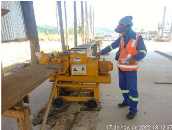
Foto 101 – Máquina de Dobra de Aço inspecionada na Central de Armação. (Data:17/11/2022)
