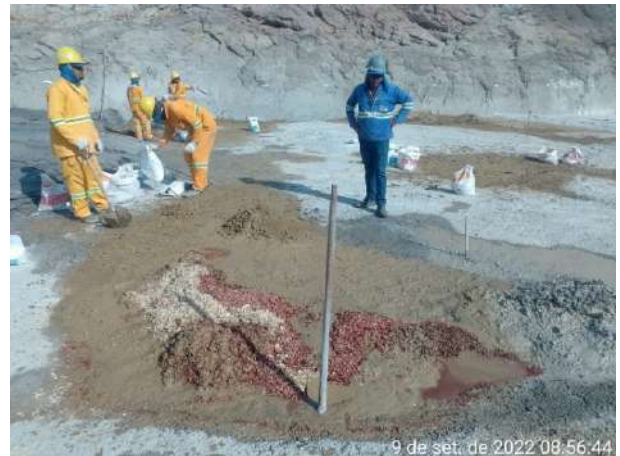
Foto 28 – Vista dos colaboradores realizando a remoção dos resíduos perigosos na frente de serviço decorrente de vazamento de equipamento. (Data:09/09/2022)
