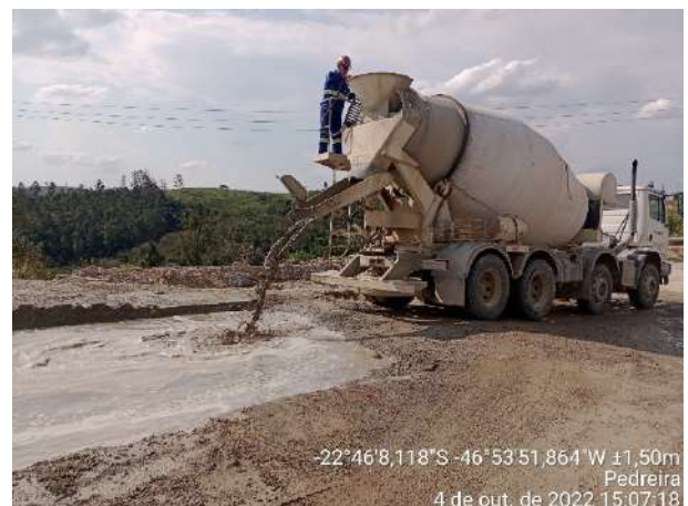
Foto 182 – Sistema de Tratamento de Efluentes para lavagem de bicas de betoneira no canteiro da usina de concreto. (Data:04/10/2022)
