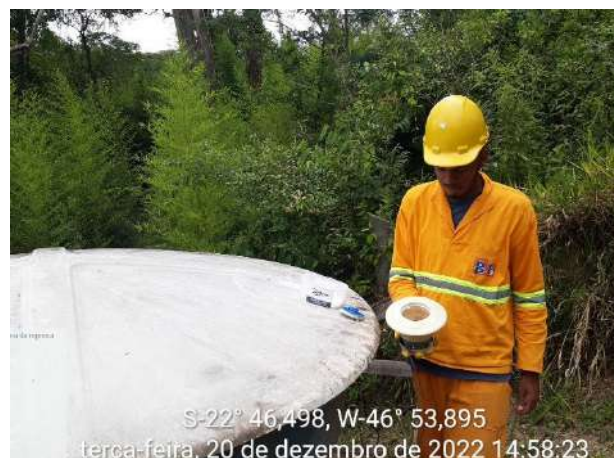
Foto 81 – Adequação de dosagem de cloro na caixa de água disposta na frente de serviço. (Data:20/12/2022)
