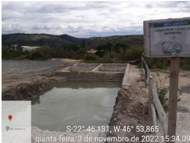
Foto 183 – Sistema de Tratamento de Efluentes utilizado para coleta de resíduos de concreto das betoneira. (Data:03/11/2022)
